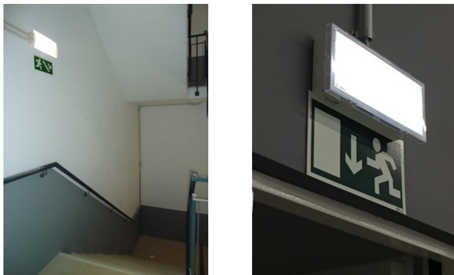
Figura 7 - Exemplos de má prática de instalação de luminárias de emergência
