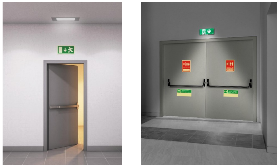
Figura 8 - Exemplos de boa prática de instalação de luminárias de emergência
